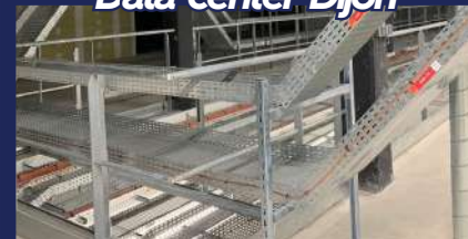
Data center Dijon
